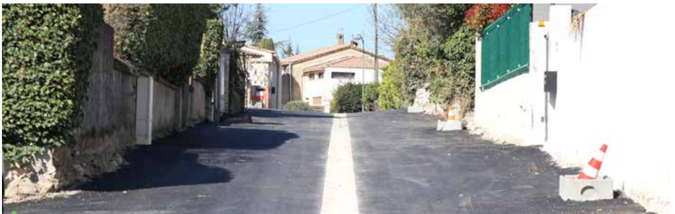
Impasse de l'Espigoulier : création d'un caniveau central raccordé au réseau pluvial afin de collecter les eaux de pluies.
