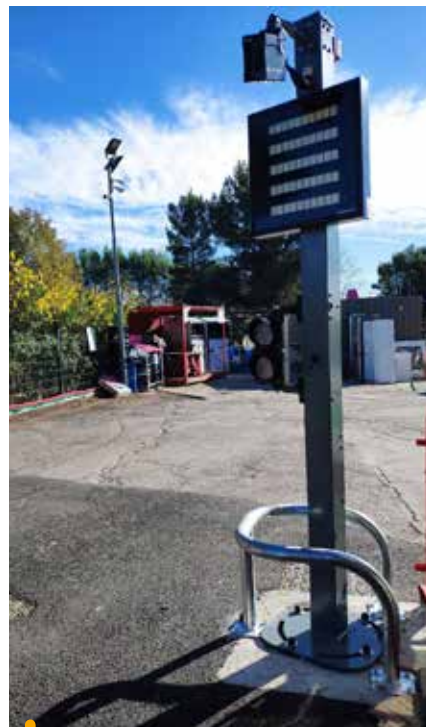
Accès des véhicules par reconnaissance de plaque à la déchetterie de Venelles
