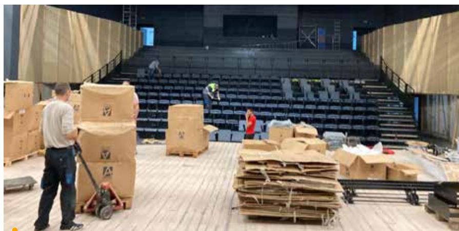
Pose des gradins rétractables dans la grande salle de spectacle - Novembre 2022. À voir aussi en vidéo !
